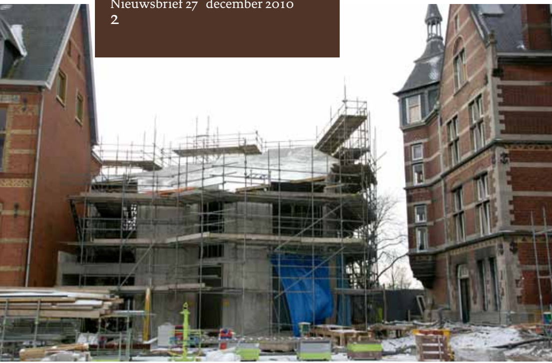
Het Studiecentrum tussen Teekenschool (links) en de Villa (voormalige directiewoning). Kenmerkend voor het gebouw zijn de getande grondvorm en de grote hellingshoek van het dak. Foto: J.P. van Eesteren
